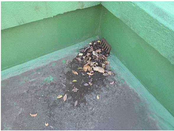
손상내용 검수실 외부 옥상 배수구 막힘 손상원인 공용기간 증가
