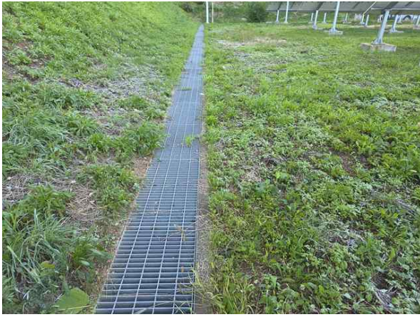
손상내용 배수지 주변 사면 토사유실(상태양호)
