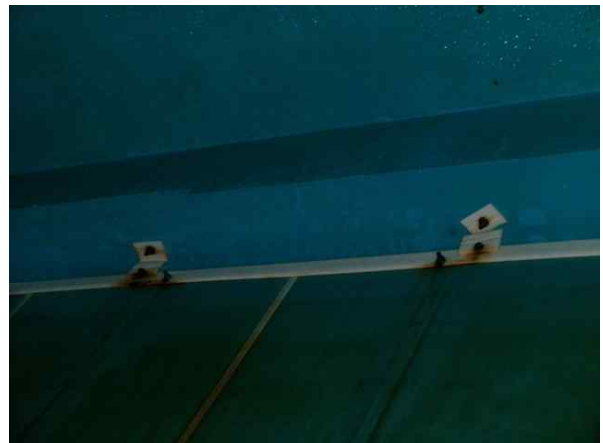
손상내용 1지 도류벽 브라켓 파손 손상원인 공용기간 증가
