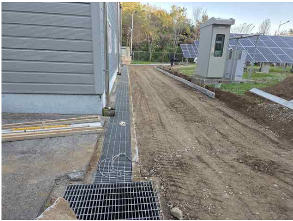
손상내용 배수로 상태현황
