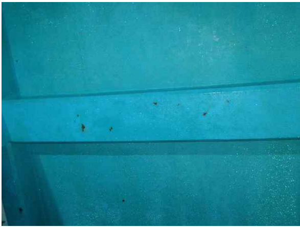
손상내용 1지 상부슬래브 녹물 손상원인 피복두께 부족
