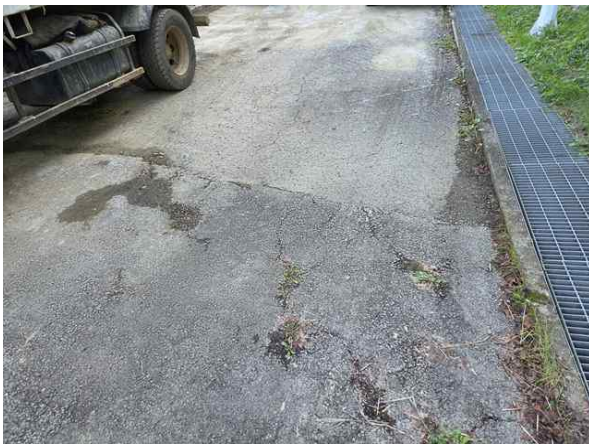
손상내용 배수지 장내 포장부 균열
