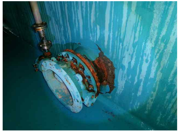
손상내용 1지 벽체 도장박리 손상원인 공용중 열화
