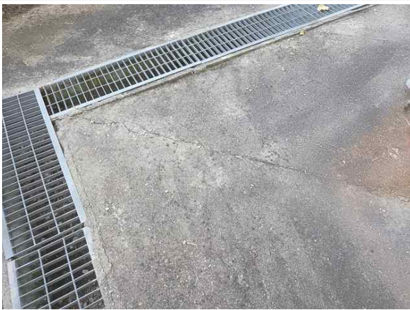
손상내용 검수실 외부 바닥기초 균열 손상원인 건조수축, 온도변화
