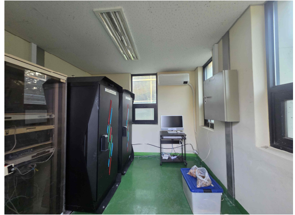
전기실 내부 전경
