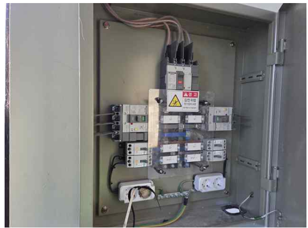
손상내용 전기실 전력 배전반 상태양호 손상원인 -
