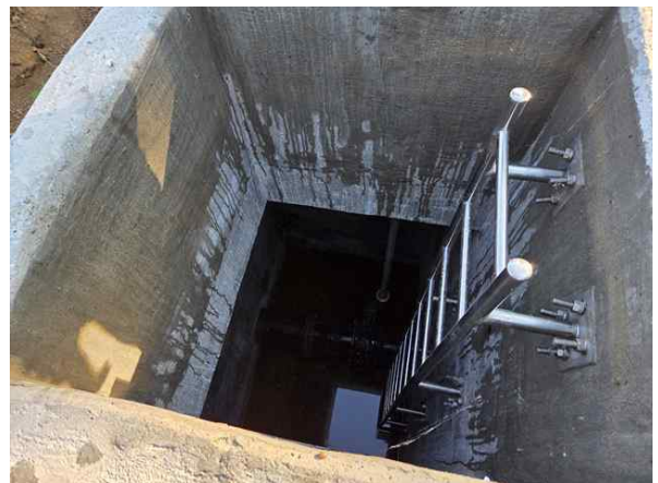
유입밸브실 사다리 현황
