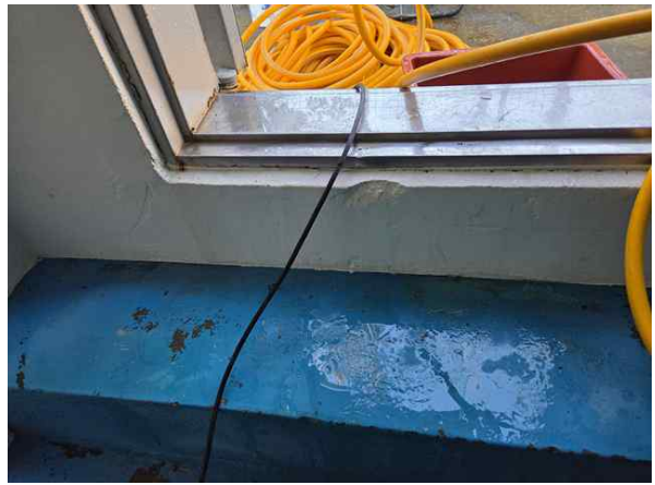
손상내용 검수실 내부 배면 벽체 파손 손상원인 외부충격
