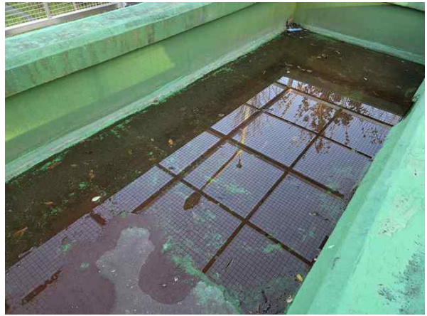
손상내용 검수실 외부 옥상 채수 손상원인 배수구 막힘
