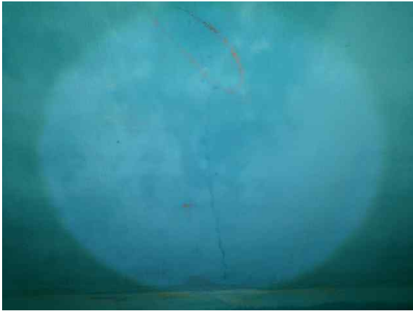
손상내용 1지 벽체 균열(0.3mm미만) 손상원인 건조수축
