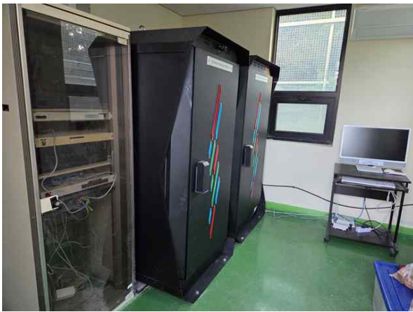
손상내용 전기실 전기설비 상태양호 손상원인 -
