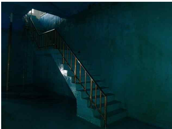
배수지 계단 안전난간 현황
