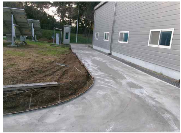
손상내용 배수지 장내 포장부 상태현황
