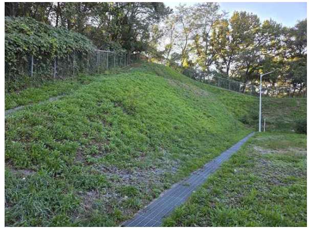
손상내용 사면(성토부) 상태현황
