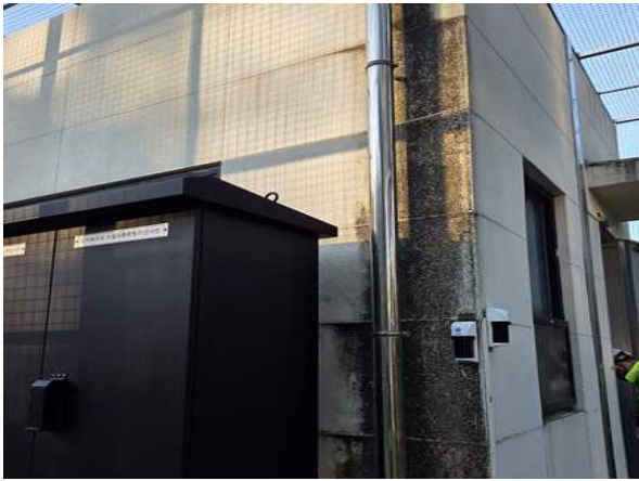
손상내용 검수실 외부 벽체 누수흔적 손상원인 배수구 막힘
