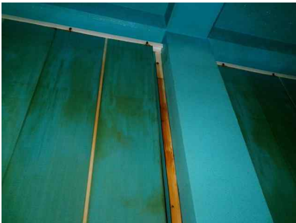
손상내용 1지 도류벽 마감재 이격 손상원인 공용중 열화
